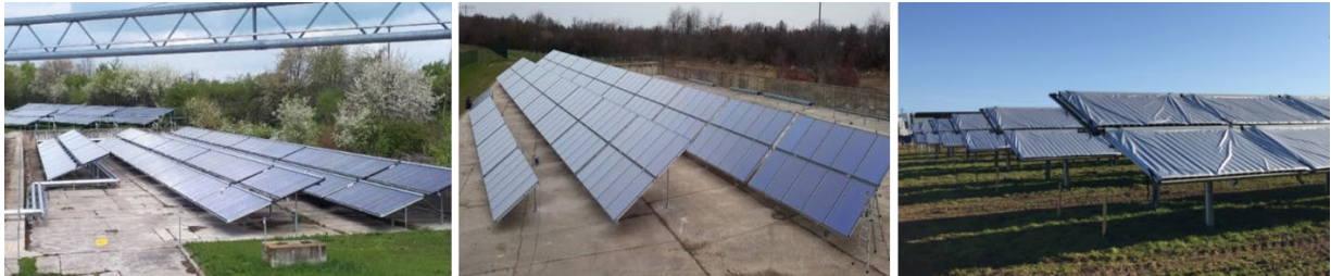
Abbildung 14: Solarthermie-Anlagen in Erfurt und Mühlhausen 77
